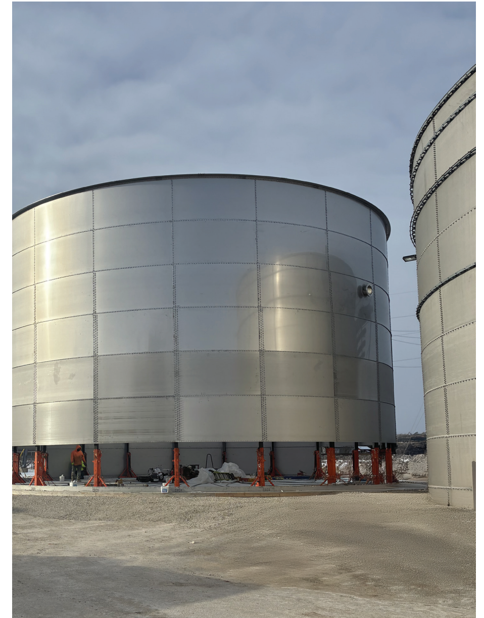
→ Installations de traitement des eaux usées à l'usine d'Agropur de Weyauwega, au Wisconsin, visant l'amélioration de la qualité de l'eau rejetée
