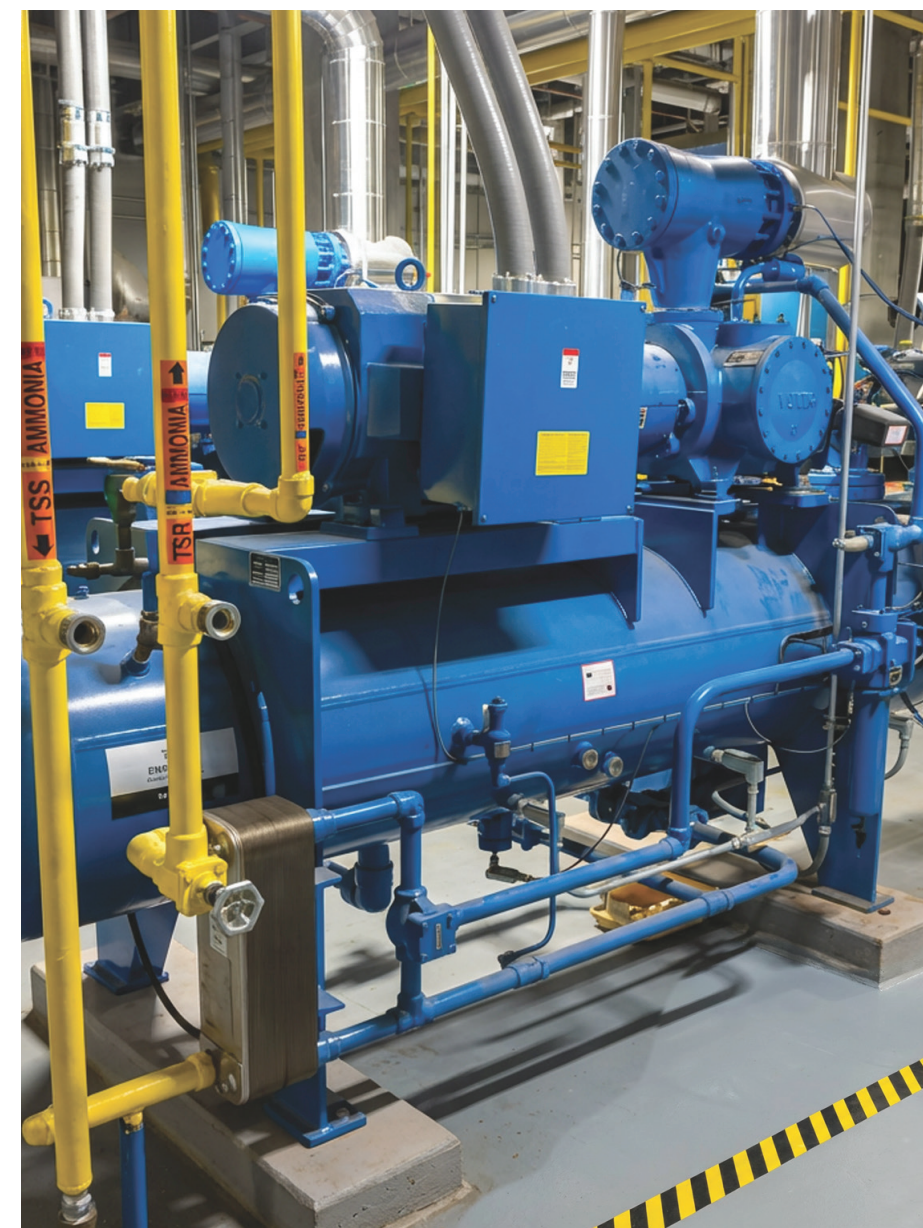
→ Compresseur de réfrigération à l'ammoniac à l'usine d'Agropur de Luxembourg, au Wisconsin
